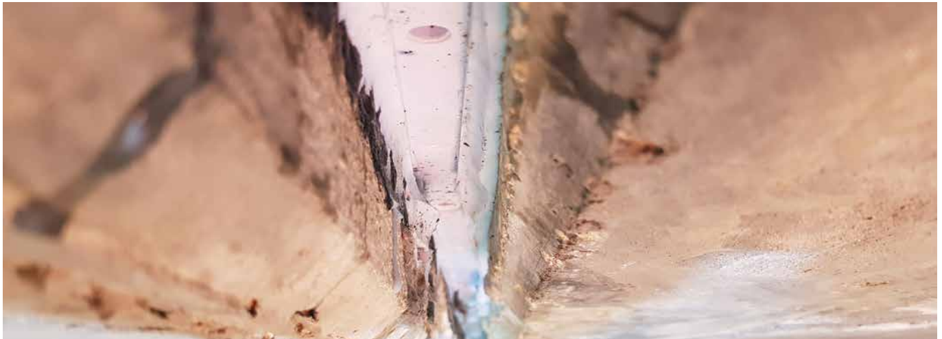
Erfolgreiche Sanierung der Fuge mit dem DESOI Quick Seal und dem Rechteck-Stahlpacker | Réparation réussie du joint avec le DESOI Quick Seal et l'injecteur en acier rectangulaire
