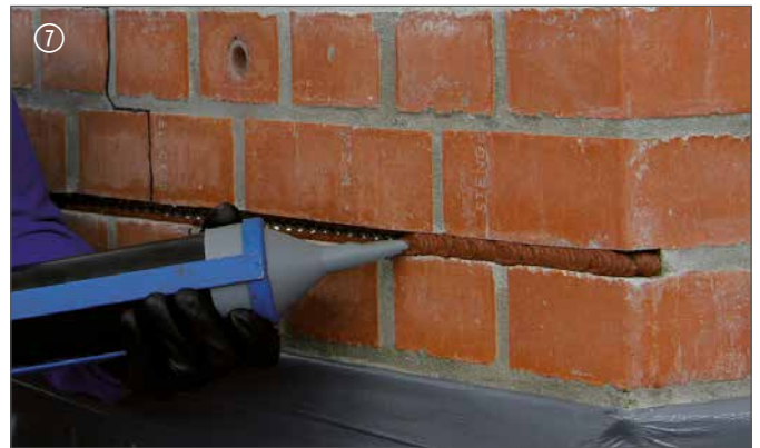
7 Zweite Lage DESOI Spiralanker einbringen | Remplir le joint d'une couche de mortier d'ancrage
